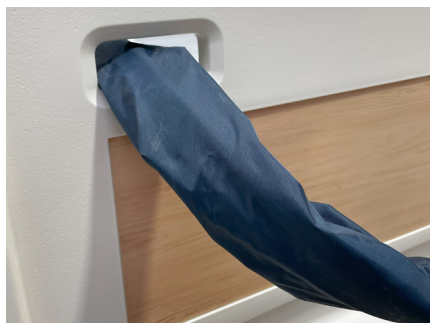
Führung der Luftschläuche
